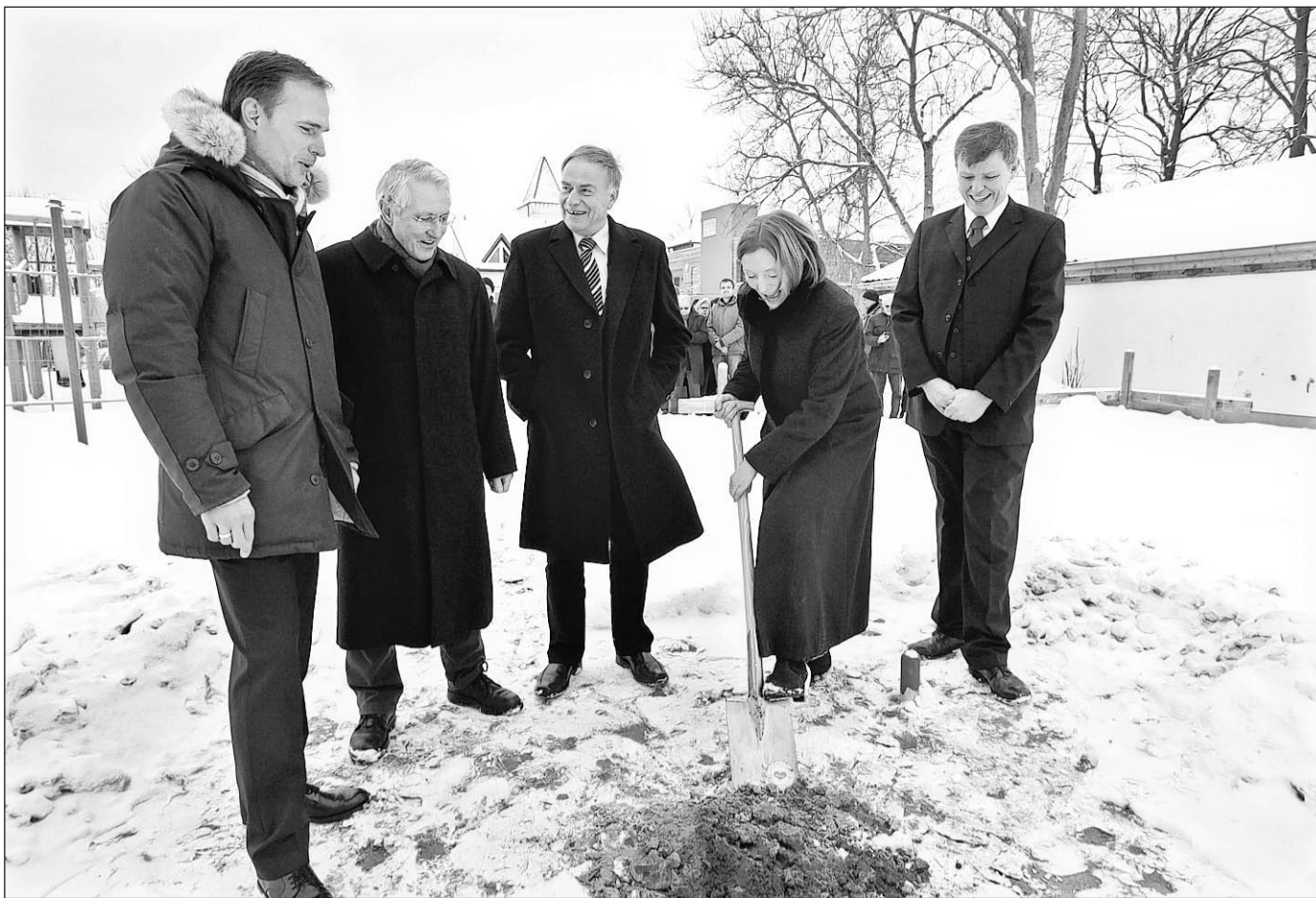
Spatenstich für die neue Therapie-Kita der Buckower Mutter-Kind-Klinik „Waldfrieden“: Nacheinander vollzogen Architekt Roman Lichtl, Bürgermeister Peter-Alexander Block, Landtagspräsident Gunter Fritsch, Klinikleiterin Katja Wolle und Geschäftsführer der gemeinnützigen Kur + Reha GmbH Melcher Franck (v. l.) den symbolischen Akt.
